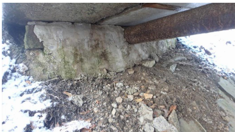
Opěra - rozpad sanace.
