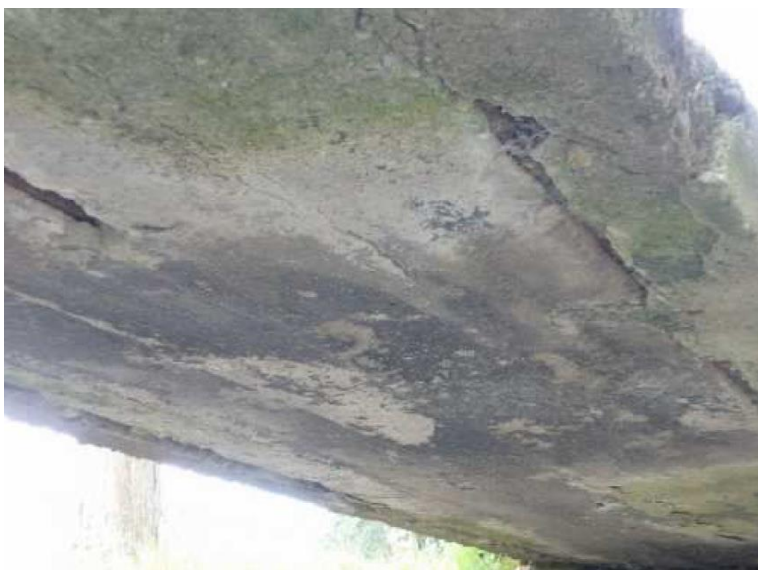
Koroze odhalené výztuže.
