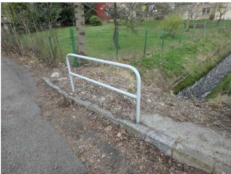
Nevhodné zábradlí na propustku.
