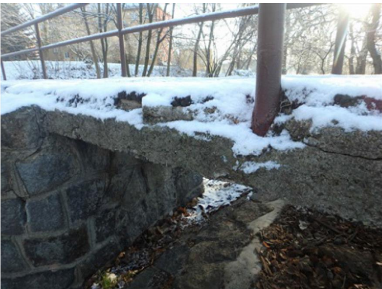
Degradace betonu lávky.
