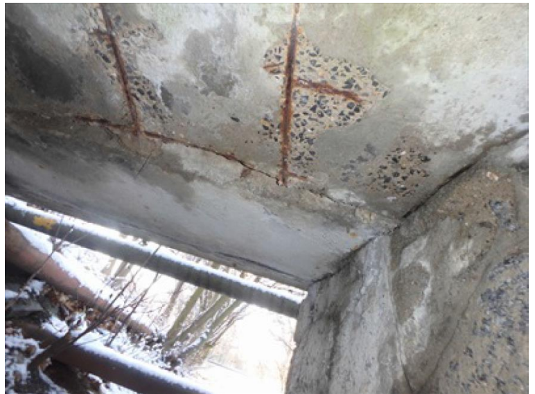
Koroze výztuže nosníků na podhledu nosné konstrukce.
