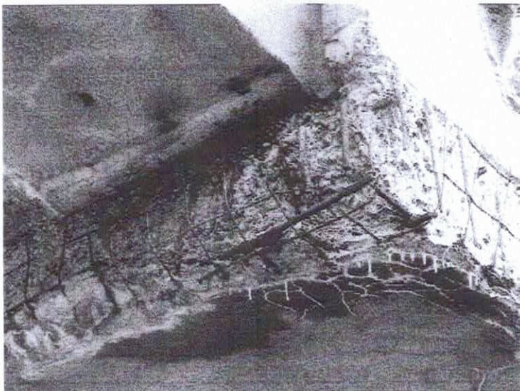
Hlubková degradace betonu a koroze obnažené výztuže stativa pilíře.
