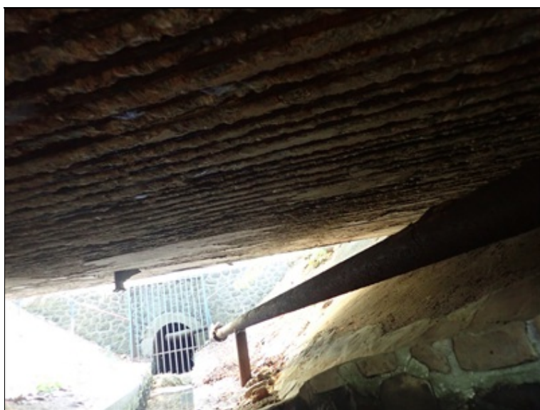
Odhalená podélná výztuž na podhledu nosné konstrukce.
