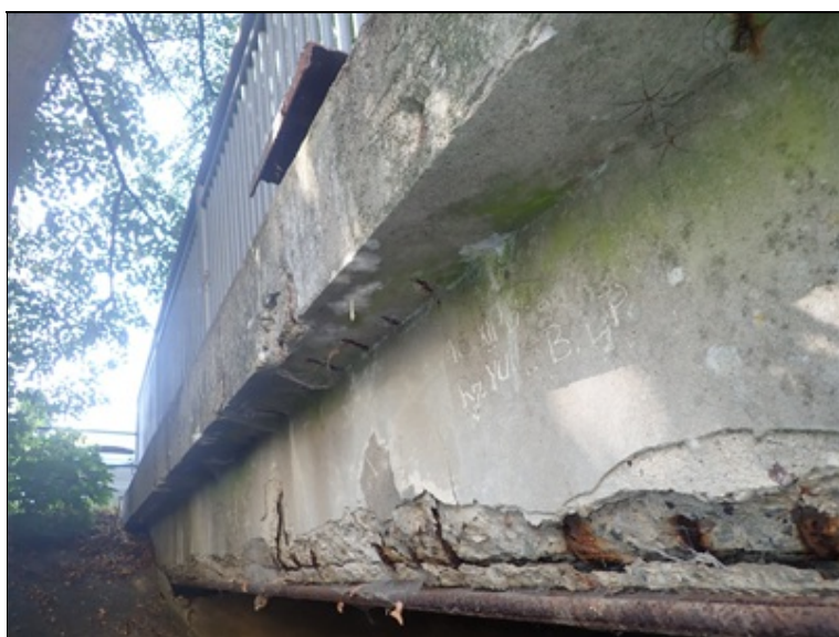
Koroze výztuže římsy.
