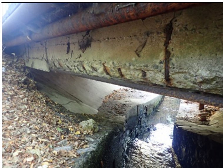
Odhalené třmínky nad podélnou výztuží.
