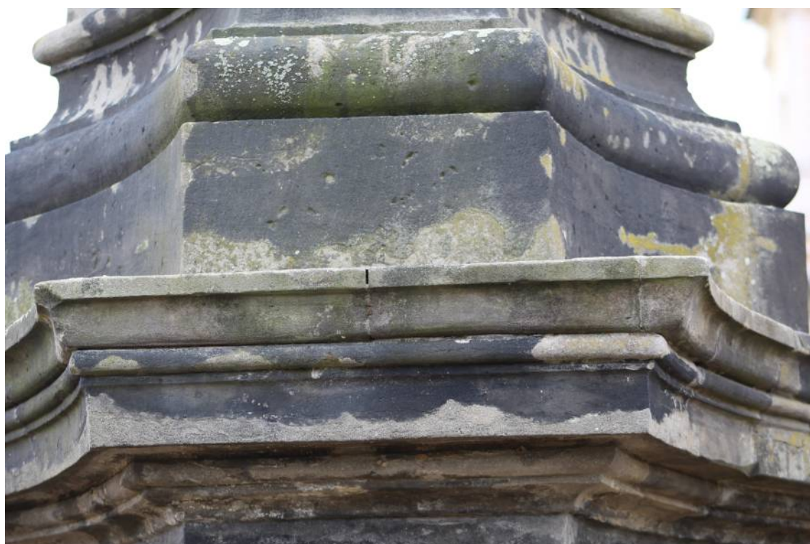
Profilovaná římsa podstavce - četná mechanická poškození, mikrovegetace na povrchu, dožitě novodobé doplňky.
