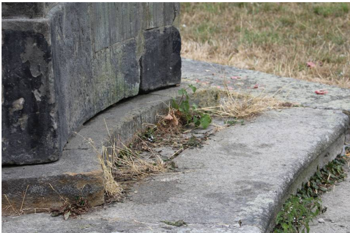
Podstavec a dvoustupňové schodiště - dožité a chybějící spáry, vrstvy mikrovegetace i prorůstání trávy mezi stupnicemi.
