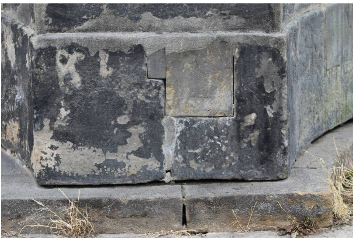
Podstavec sloupu - četná mechanická poškození, dožitá doplňky, chybějící spáry, neprodyšné černé krusty.
