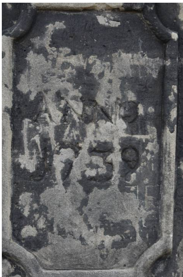
Kartuše na bocích podstavce - četná mechanická poškození, dožité novodobé doplňky.
