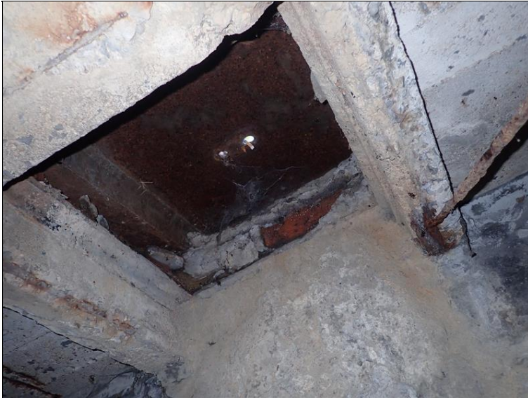
Koroze uliční vpusti.
