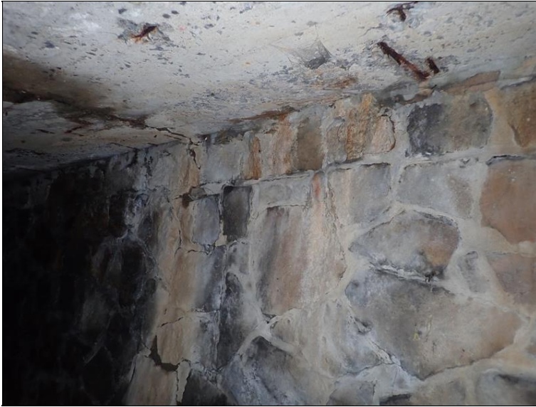
Stopy po zatékání z úložného prahu.
