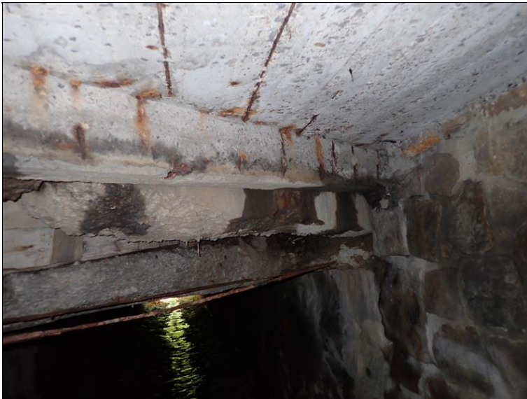
Stopy po zatékání v místech změny průřezu.
