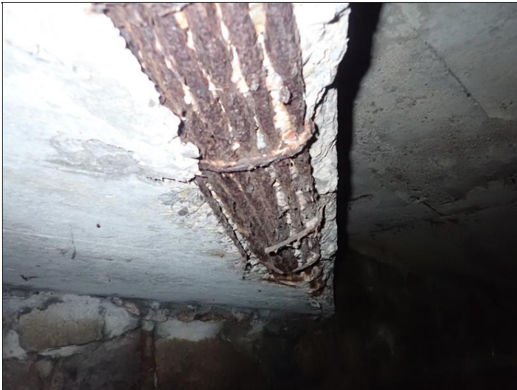
Koroze odhalené výztuže.
