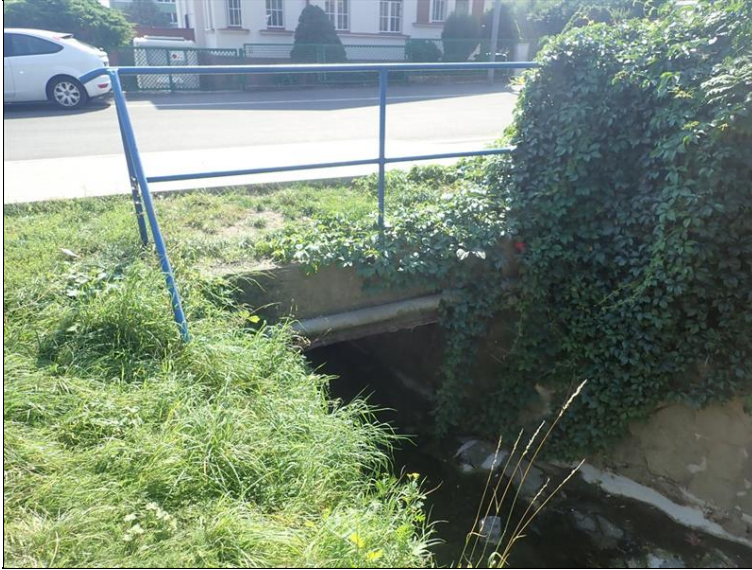
Vegetace v místech vtoku do mostního otvoru.
