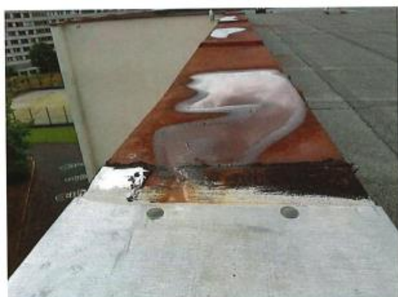
Foto 17 – pohled zkorodované oplechování atiky pavilonu F.
