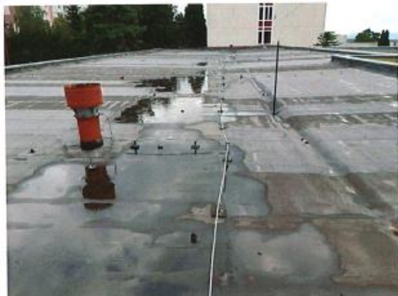
Foto 19 – kaluže dlouhodobého charakteru na pavilonu A.
