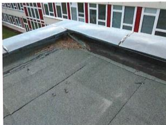
Foto 17 – pohled na shrnutý vrchní asfaltový pás atiky pavilonu A1
