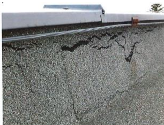
Foto 18 – pohled na stékající asfaltovou vrstvu pod oplechováním atiky pavilonu A2.
